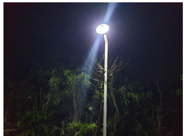
Gambar 7. Lampu Penerangan Jalan Dusun Sumbergelang Desa Sumberdem
