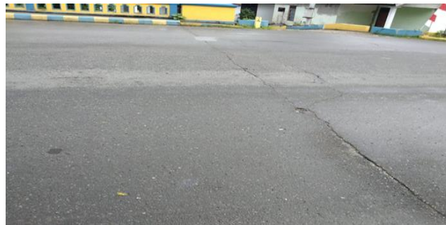
Gambar 3. Expansion Joint Terjadi Kretakan
