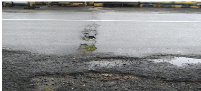
Gambar 7. Retak Pada Sambungan Muai/susut
