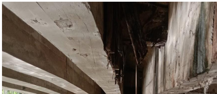
Gambar 8. Beton Keropos Pada Elemen Gelagar Jembatan
