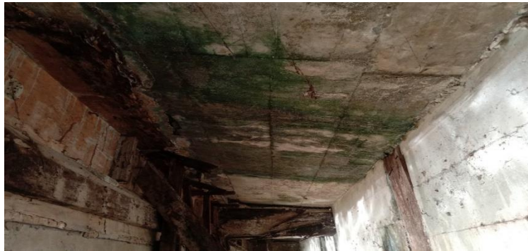
Gambar 9. Rembesan Pada Elemen Lantai Jembatan
