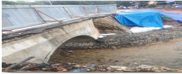
Gambar 1. Keruntuhan Elemen Sandaran Akibat Longsor
